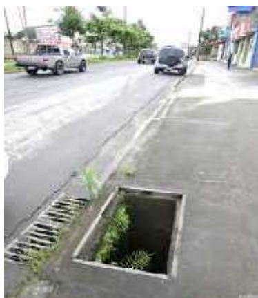
SUMIDERO AGUAS LLUVIAS
