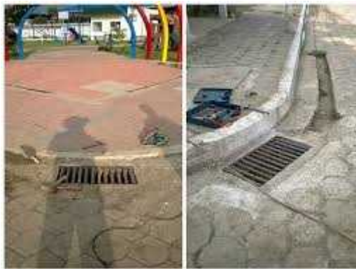
SUMIDERO AGUAS LLUVIAS
