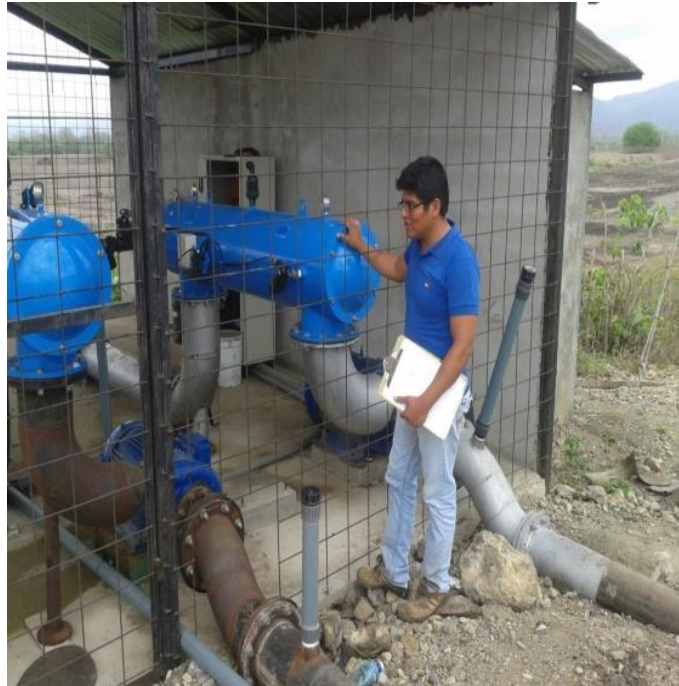
Figura 7A. Instalación de bombeo de la Represa San Vicente
