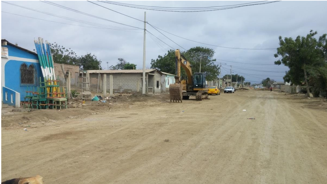
Anexo 12 Fotos de las calles lastradas en los alrededores de centro de salud
