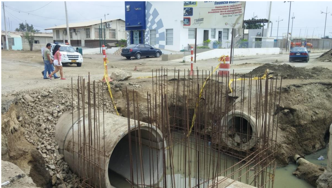
Instalaciones de desagüe cerca del centro de salud Enrique Gallo
