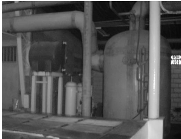
FIGURA # 12 Tratamiento de agua.
