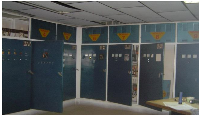
FIGURA # 24 Tablero eléctrico para el equipo.
