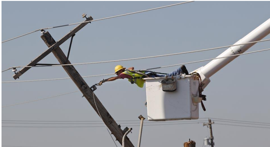
Figura N° 5: Riesgos de altura
