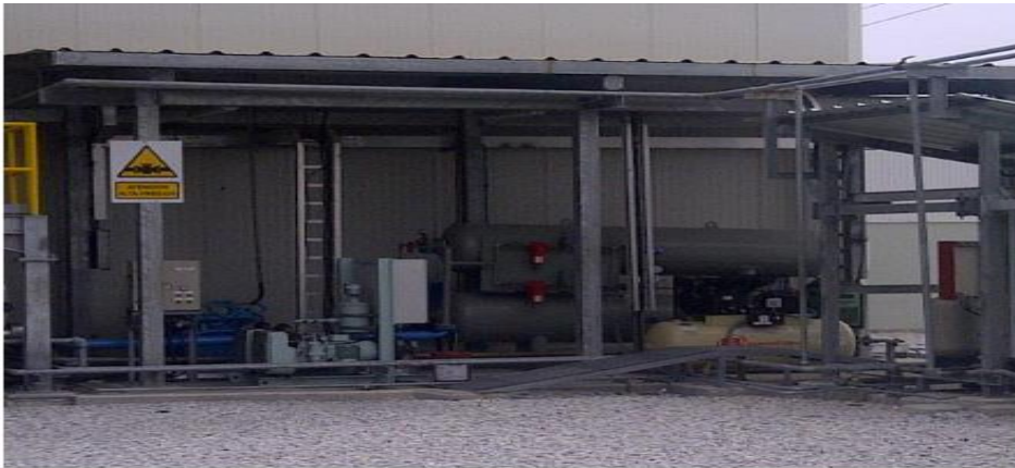
Ilustración 3 Estación de compresores
