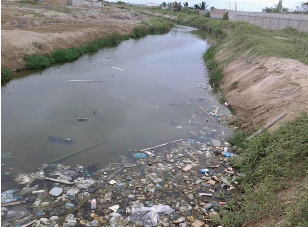
Canal para aguas lluvias lleno de basura-Sector San Raymundo
