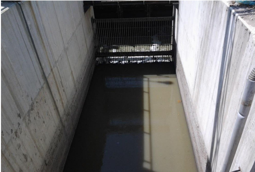
Sistemas de bombeo de aguas residuales (1)
