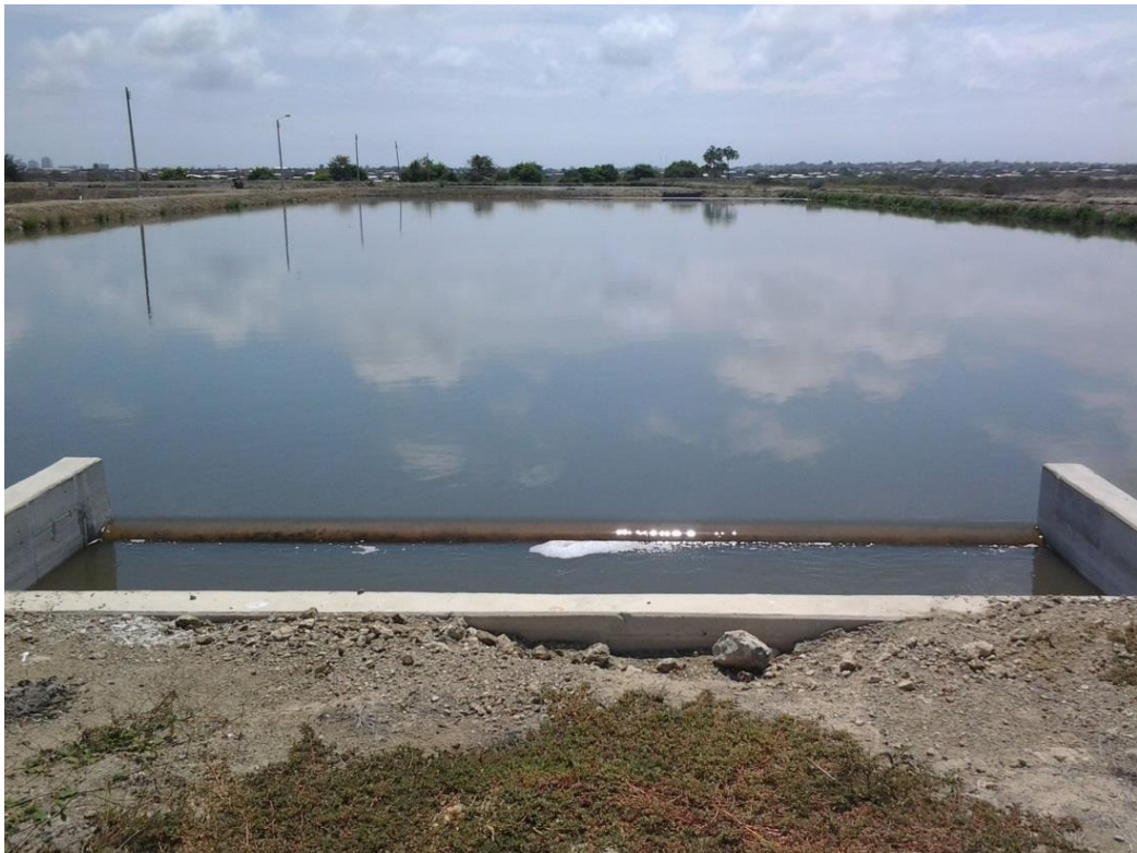
Lagunas de oxidación ubicadas en la vía Punta Carnero (2)
