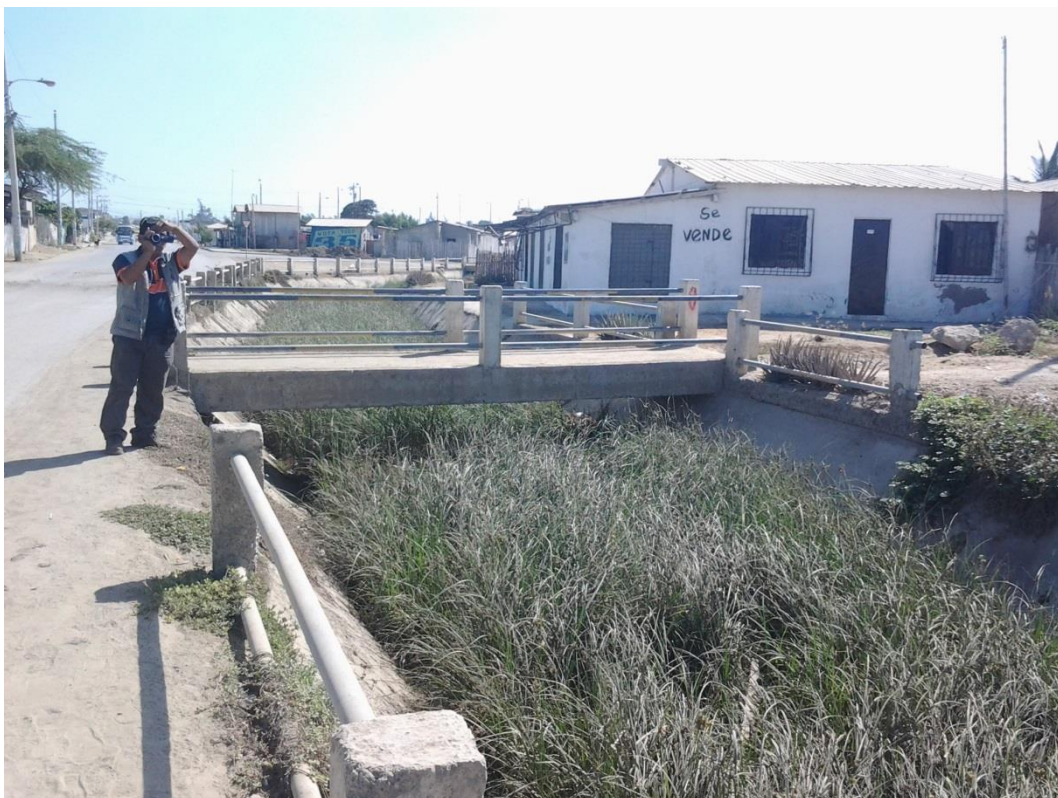
Canal para aguas lluvias lleno de malezas-Sector Ernesto González
