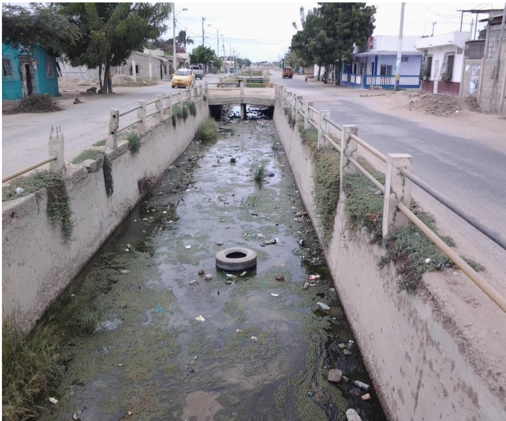
Putrefacción y contaminación ambiental en los canales de aguas lluvias y residuales,presencia de llantas y desechos sólidos
