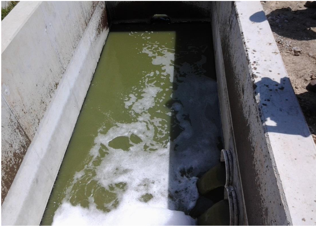
Canales de mejoramiento de aguas procesadas en lagunas de oxidación
