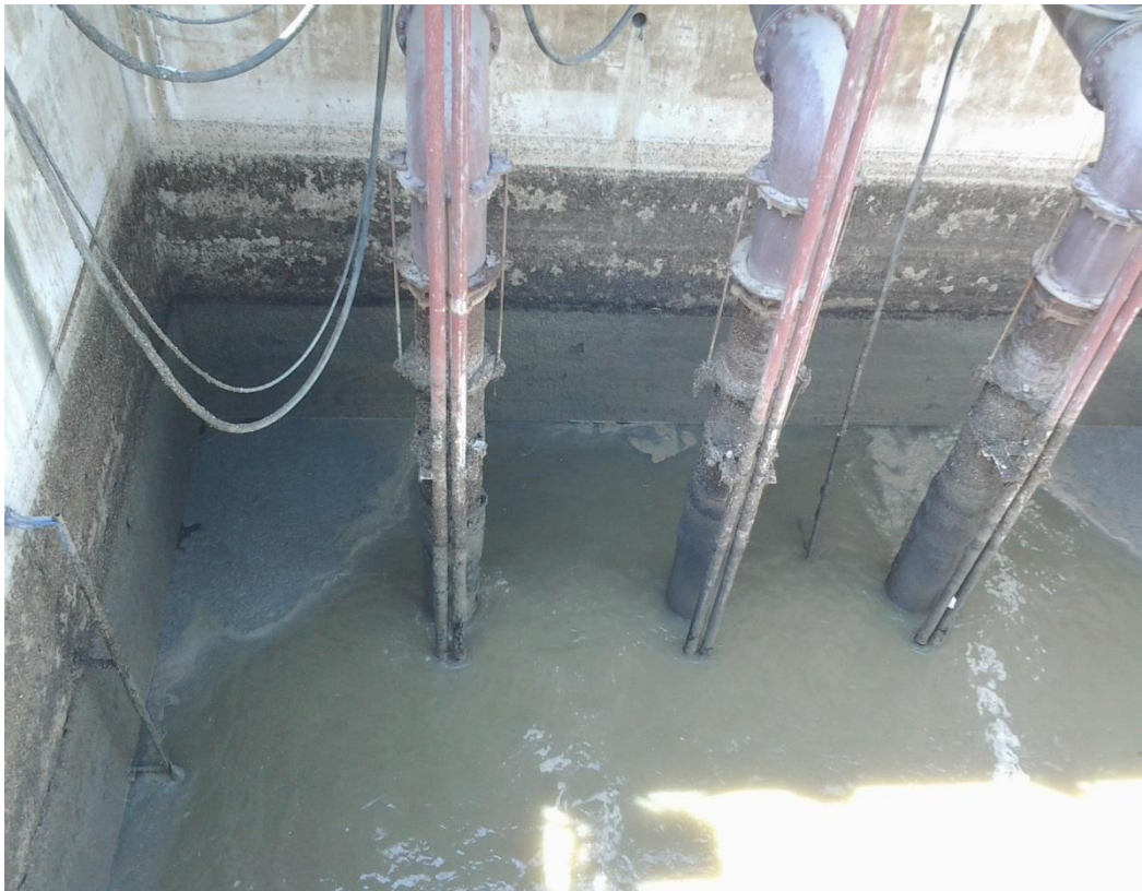
Sistemas de bombeo de aguas residuales (2)
