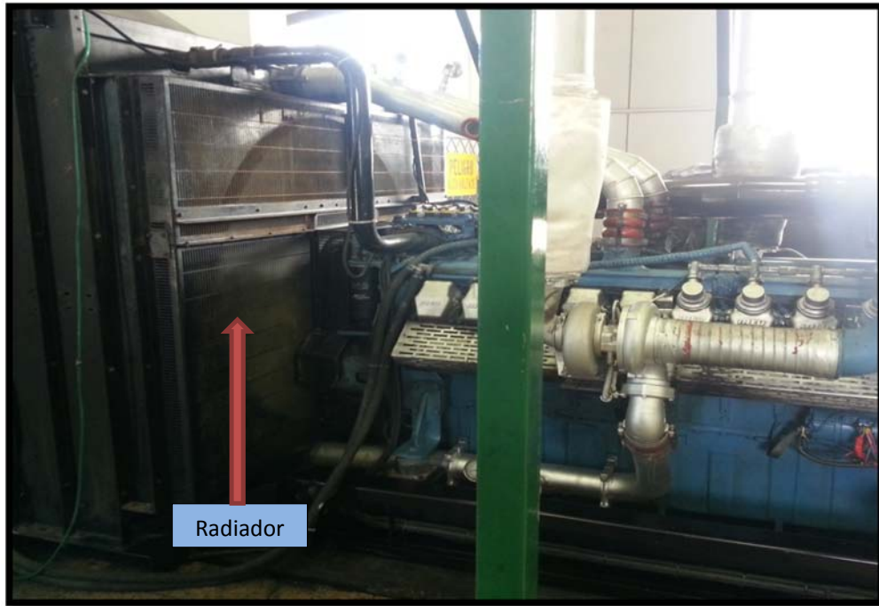
Figura # 31 Equipo De Generación Eléctrica (Radiador)
