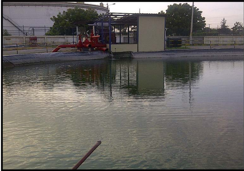
Figura # 38 Reservorio Del Sistema Contra incendios.
