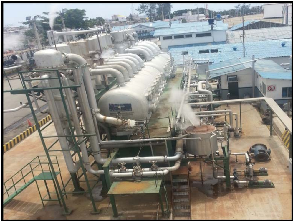
Figura # 1 Planta Desalinizadora
