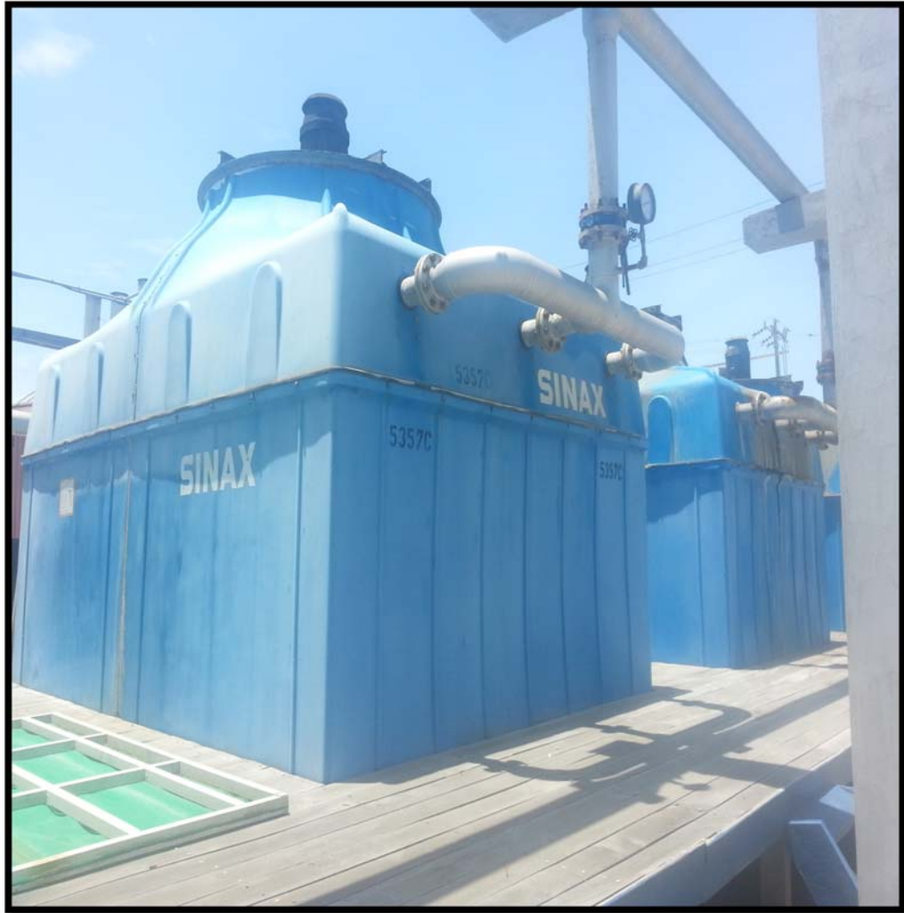
Figura # 18 Torres De Enfriamiento Marca SINAX
