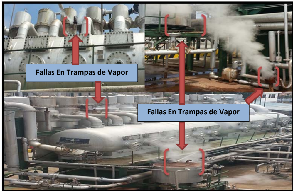
Figura # 4 Fallas En Trampas de Vapor
