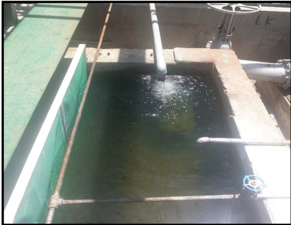
Figura # 20 Piscina De Alimentación A Torres De enfriamiento.
