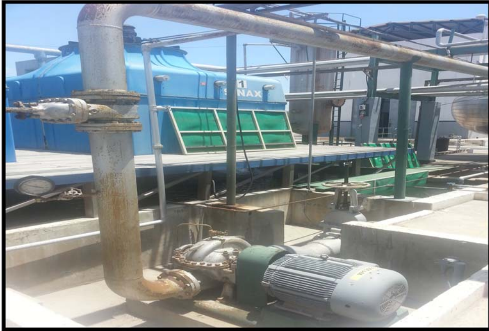
Figura # 21 Bombas de Recirculación
