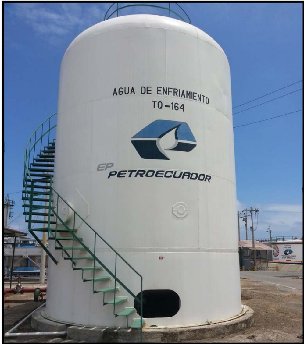
Figura # 19 Agua De Enfriamiento (tanque 164)
