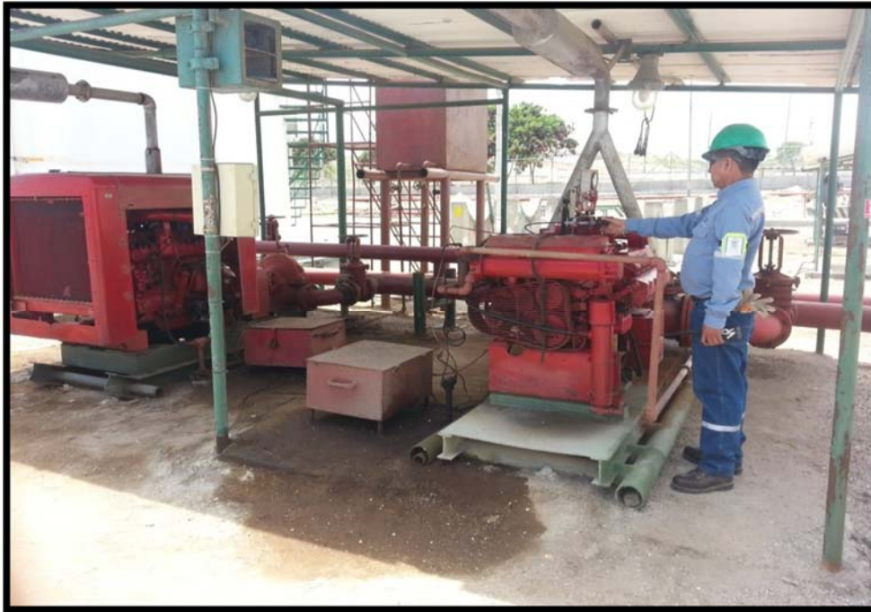
Figura # 39 Bomba Contraincendios B-Roja.
