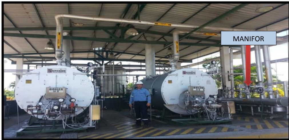
Figura # 14 Calderas Superior Boiler (manifor de distribución)
