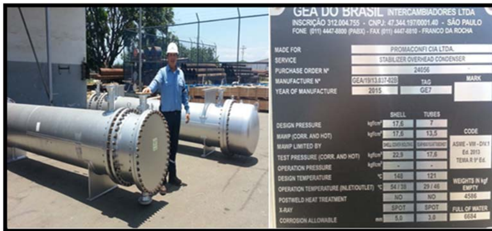
Figura # 28 Características Nuevos Intercambiadores.
