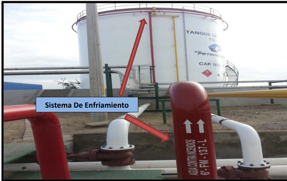
Figura # 46 Sistema De Enfriamiento (Rociadores).
