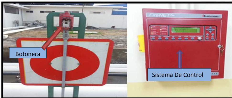
Figura # 43 Sistema De Control y Botoneras.
