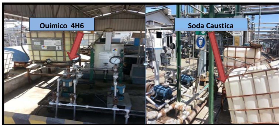
Figura # 51 Área De Preparación De Químicos.
