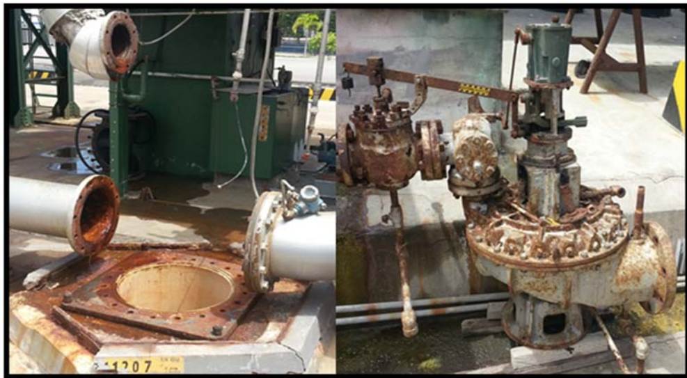
Figura # 2 Turbina a Vapor (Bomba de Recirculación)
