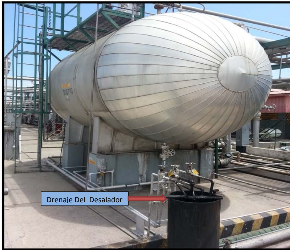
Figura # 35 Drenaje Desalador.
