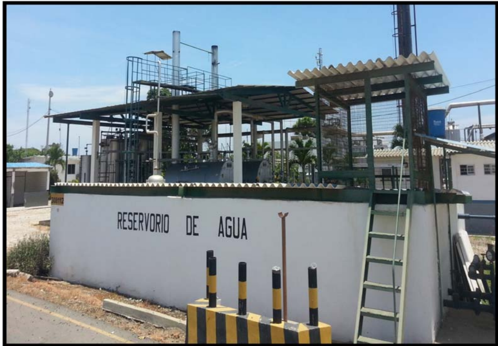
Figura # 15 Reservorio De agua Desalinizada
