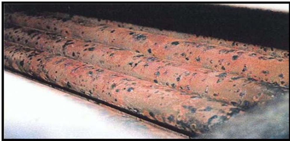
Figura # 17 Tubos Con Corrosión
