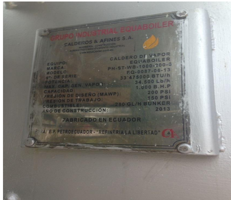
Imagen N° 10. Especificaciones de la Caldera # 5
