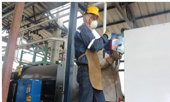
Imagen N° 12. Personal de mantenimiento.
