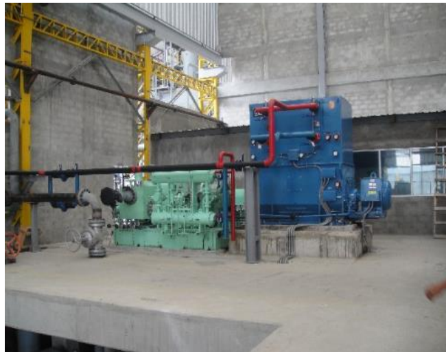
Turbo generador de energía eléctrica
