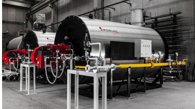
Imagen N° 28. Caldera de Fluido Térmico
