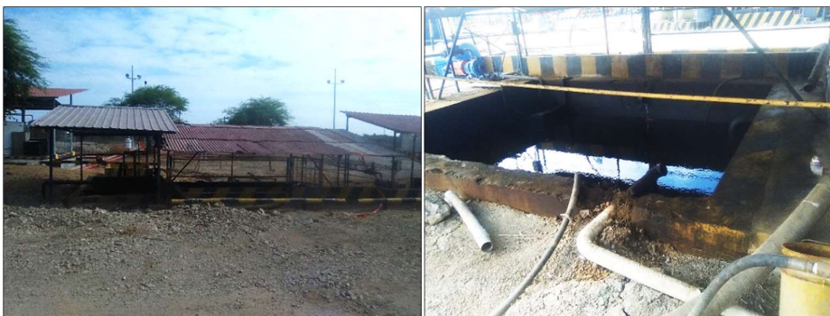
Piscina de drenajes de la planta de gasolina
