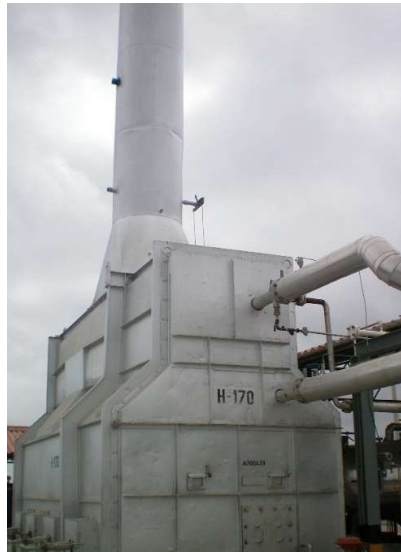
Horno H-170 de planta de gasolina
