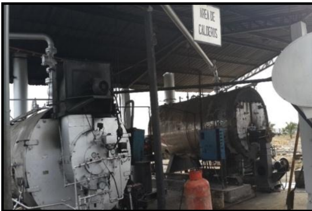
Imagen No. 11 Área de calderos
