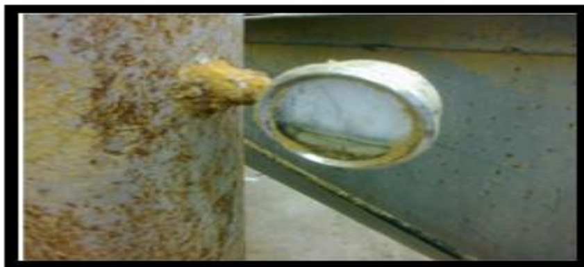
Imagen No. 20 Medidor de temperatura obsoleto
