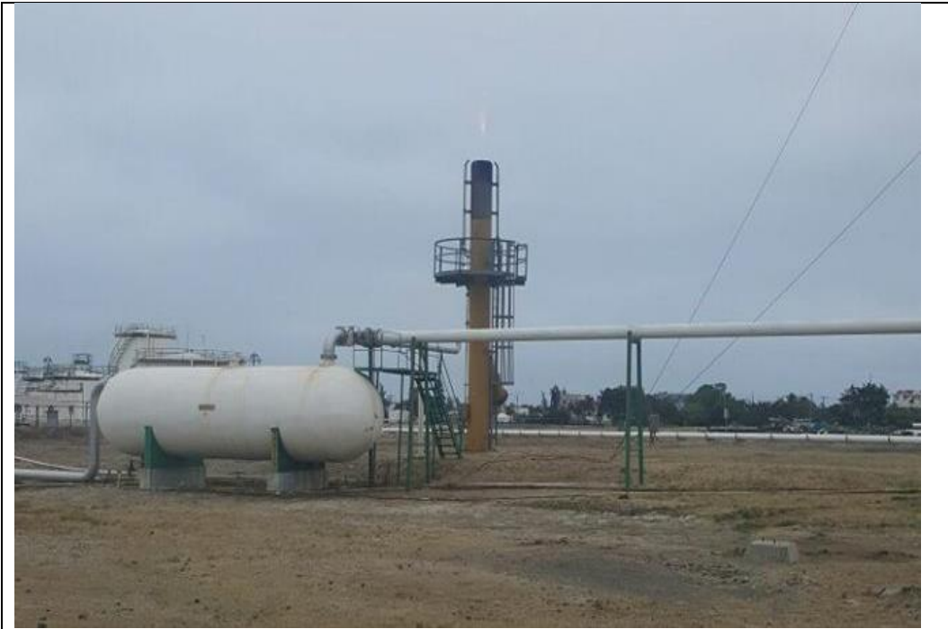
Observación acumulador de Gases de la Refinería La Libertad
