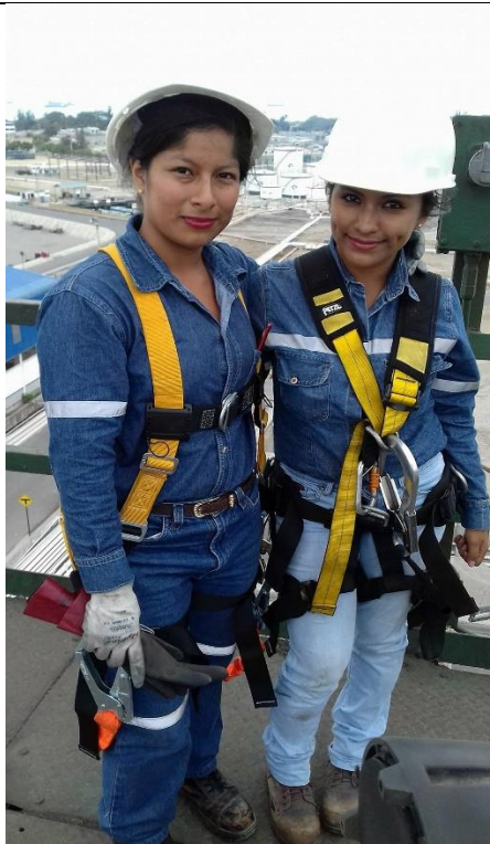
Con el equipo de seguridad personal en la Torre de la Planta Universal de la Refinería La Libertad
