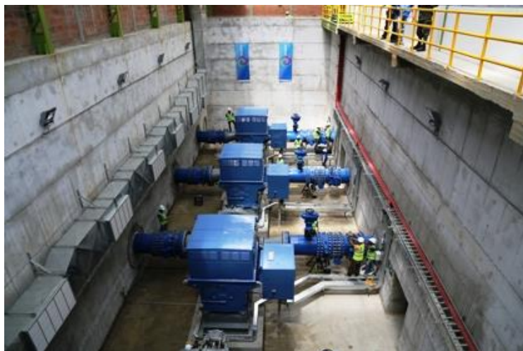
IMAGEN N° 2 ESTACIÓN DE BOMBEO
