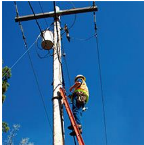
IMAGEN N° 33 CORRIENTE DE BAJA TENSIÓN
