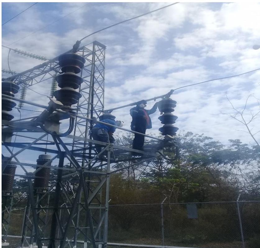
IMAGEN N° 12 RIESGO DE ORIGEN ELÉCTRICO
