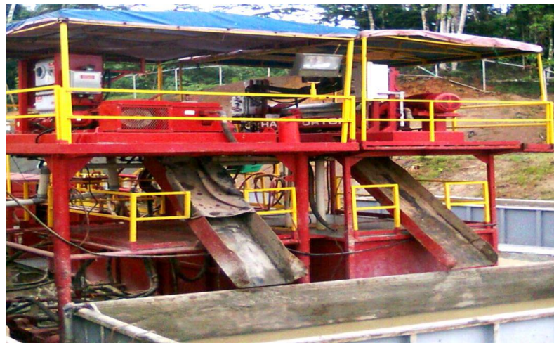
Fig. 18. Control de Sólidos. Unidad de Deshidratación.
