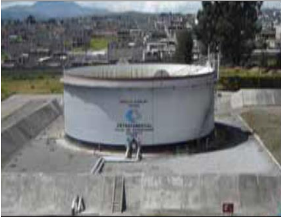
Fig.6: Tanque cilíndrico con techo flotante
