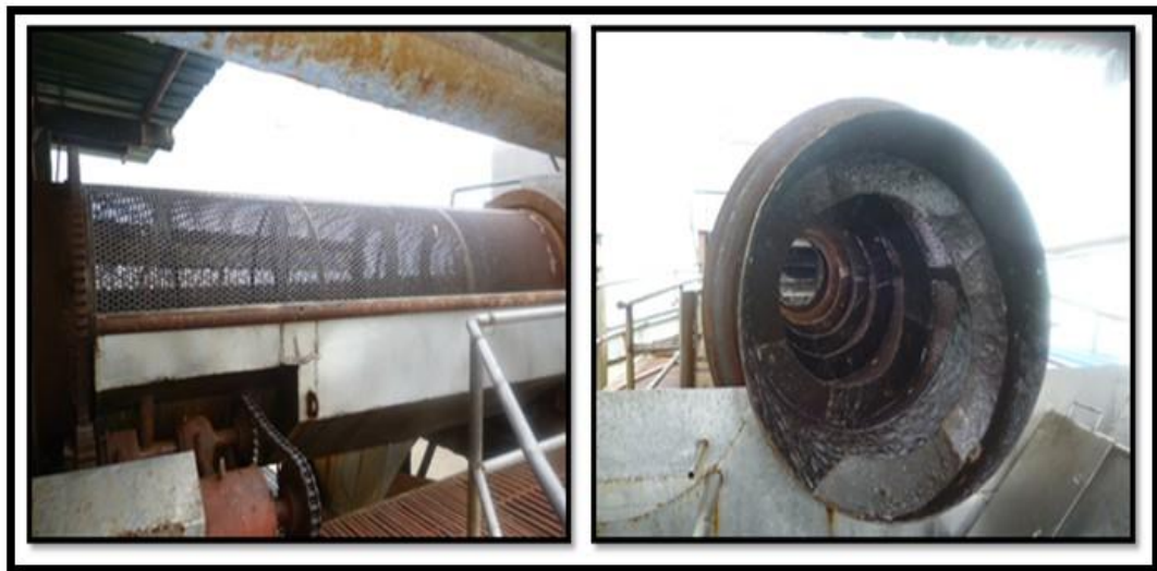
Figura N° 9 Desagüe o Desbaste
