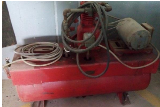
FOTO N° 8 COMPRESOR DE AIRE INDUSTRIAL
