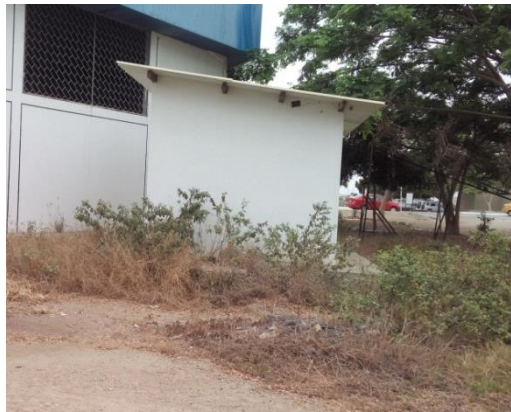
FOTO No. 16 PRESENCIA DE MALEZA EN EL EXTERIOR DEL ÁREA DE TRANSFORMADORES
