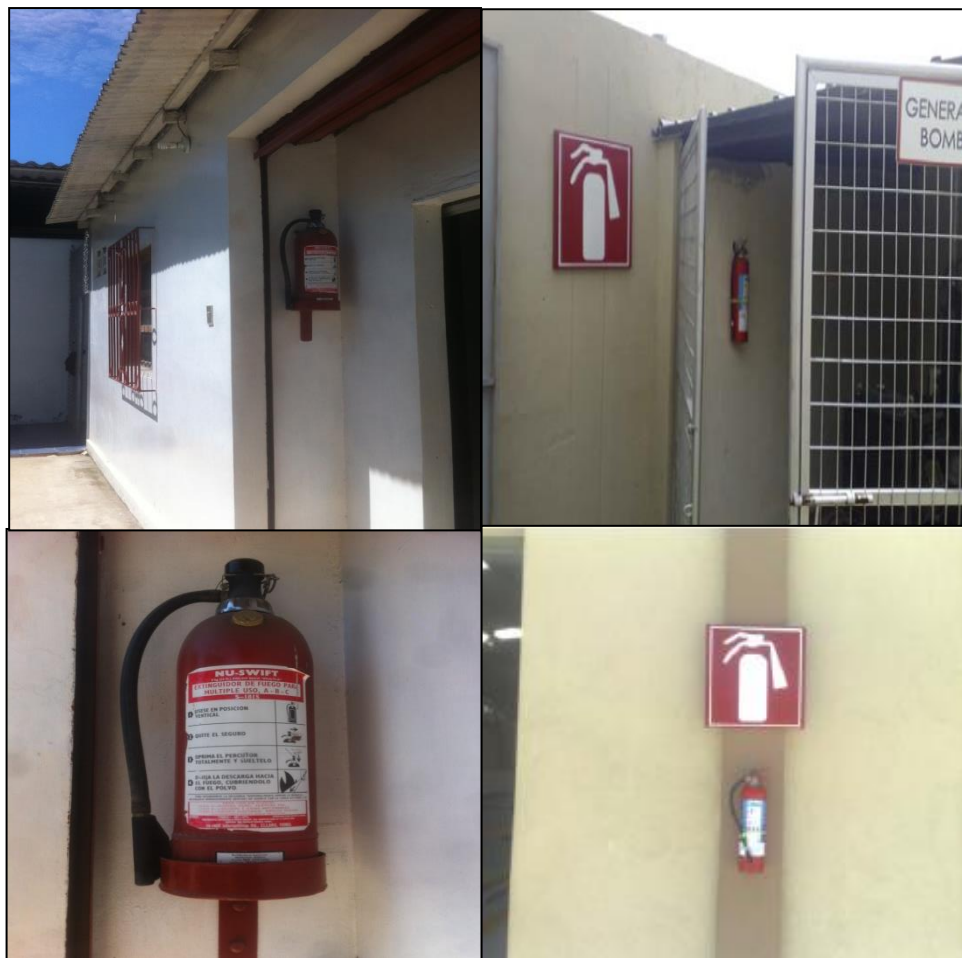
Imagen No. 22: Ubicación de Extintores
