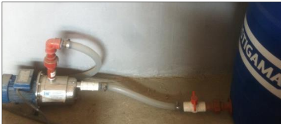
Imagen No. 14: Captación de Agua Residual
