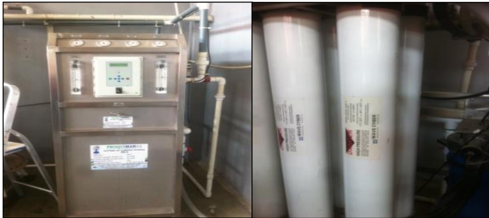
Imagen No. 13: Sistema de Ósmosis Inversa
