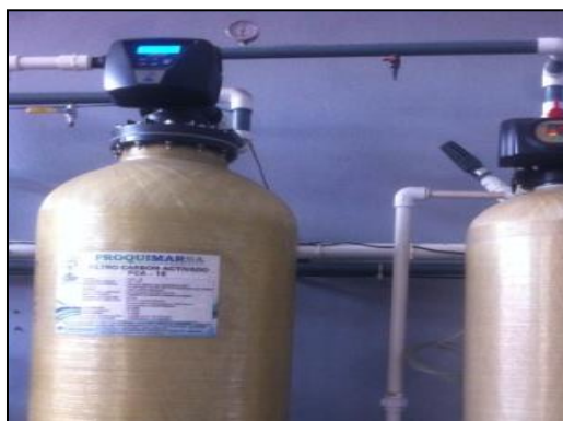
Imagen No. 10: Filtro de Carbón Activado
