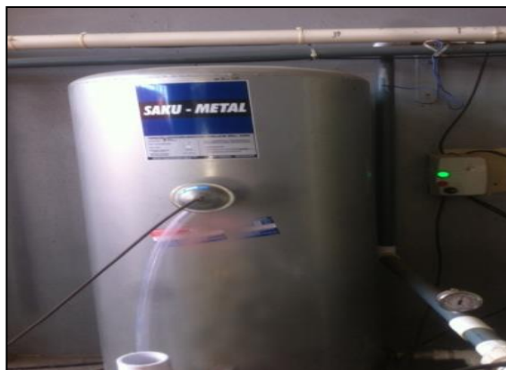
Imagen No. 8: Bombeo a los equipos de filtración
