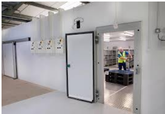
Imagen N° 25 Cámara de Frio.
