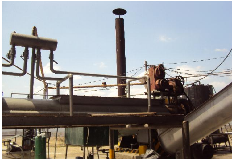
Imagen. # 29. Aislamiento de Tubería
