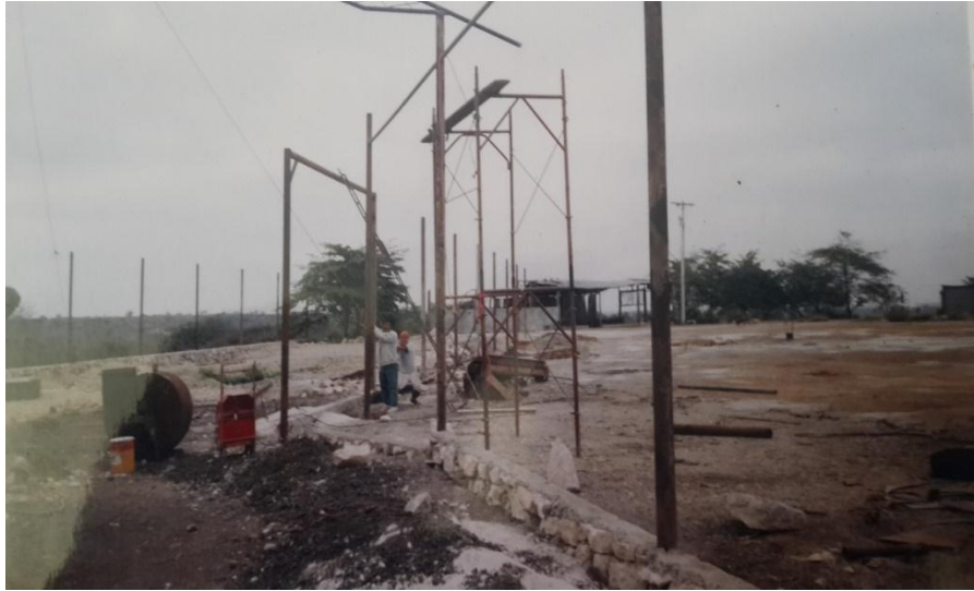
Fuente: Empresa Alterpes C.A., Asentamiento de las estructuras metálicas.
