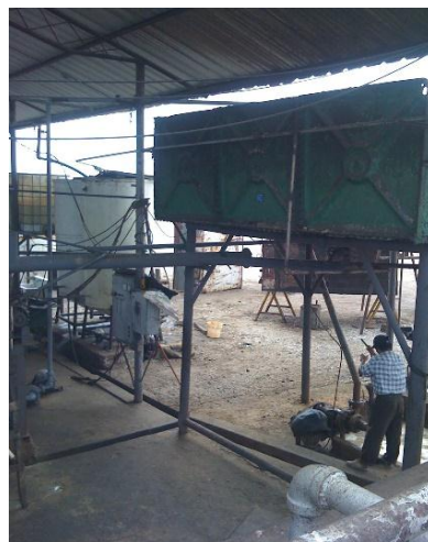
Imagen. # 25. Bombas de Presión
