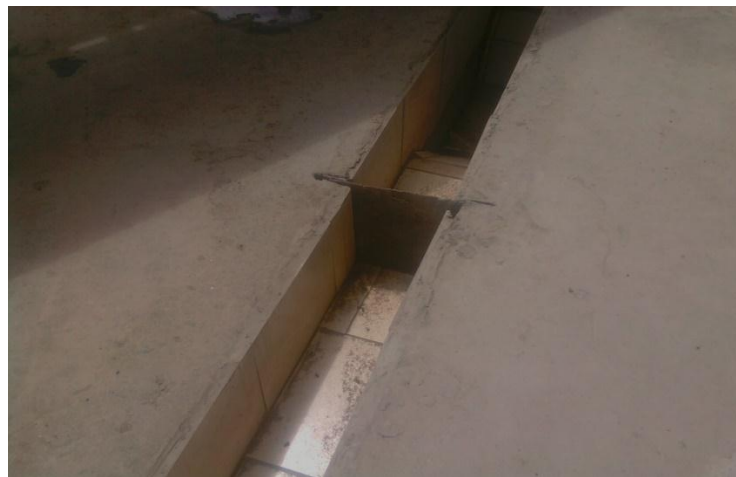
Imagen. # 21. Canaletas - abierto
