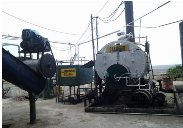
Imagen. # 26. Líneas de vapor
