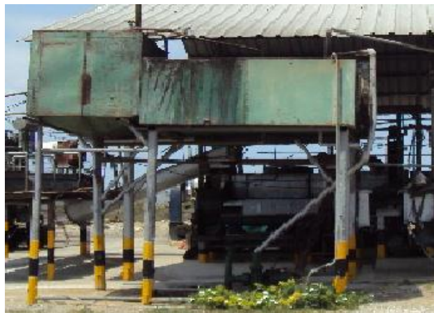
Imagen. # 27. Tanques elevados
