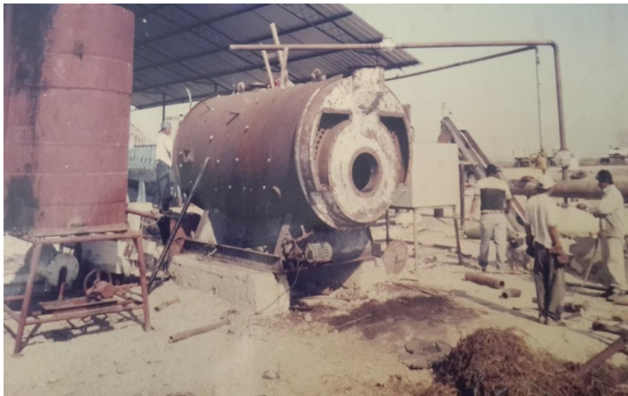
Fuente: Empresa Alterpes C.A., Asentamiento del Caldero de 150 cv con quemador de fuel oíl. Marca Thompson.
