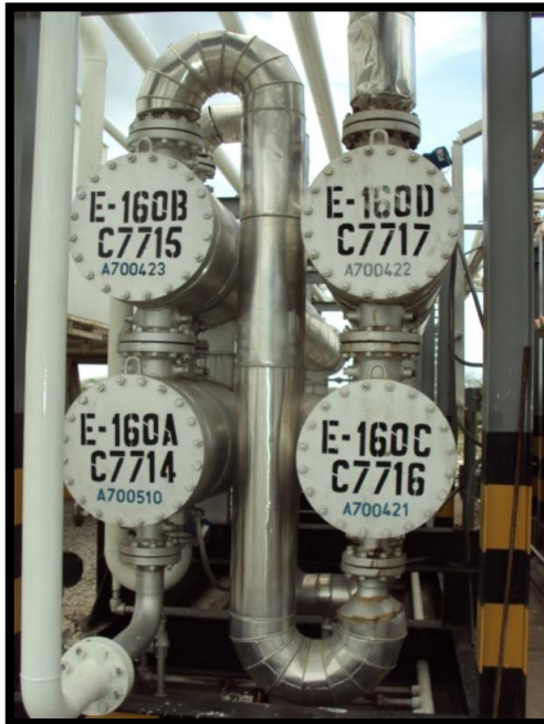
Imagen 14. Intercambiador de calor
