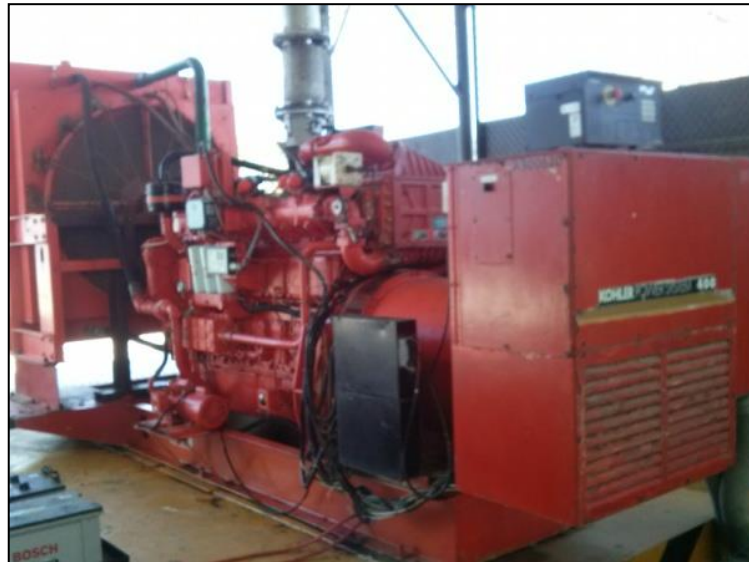
Imagen 24. Grupos electrógeno Waukesha
