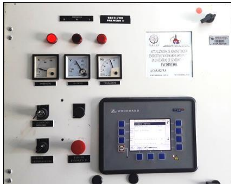
Imagen 39. Tablero de control
