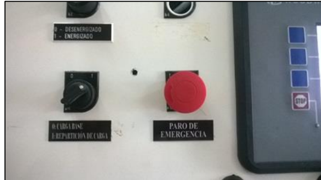
Figura 38. Selector y botonera de paro de emergencia
