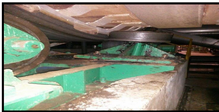
Imagen No. 24 Filtración De Lubricantes
