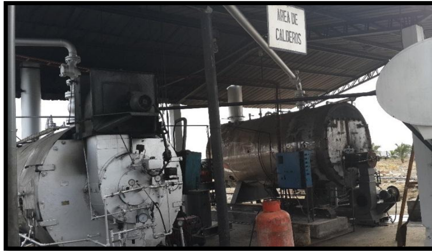
Imagen No. 13 Área De Calderos
