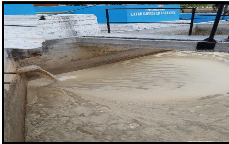
Imagen No. 18 Piscina De Almacenamiento De Aguas De Proceso
