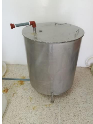
Figura 18: Tanque de Almacenamiento del desinfectante
