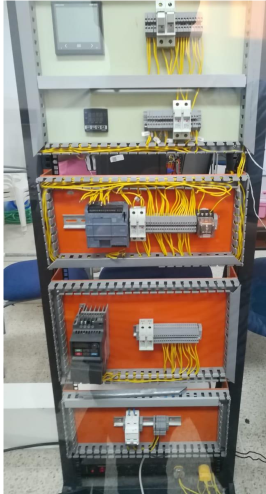
Figura 28: Tablero del laboratorio de automatización recibido.
