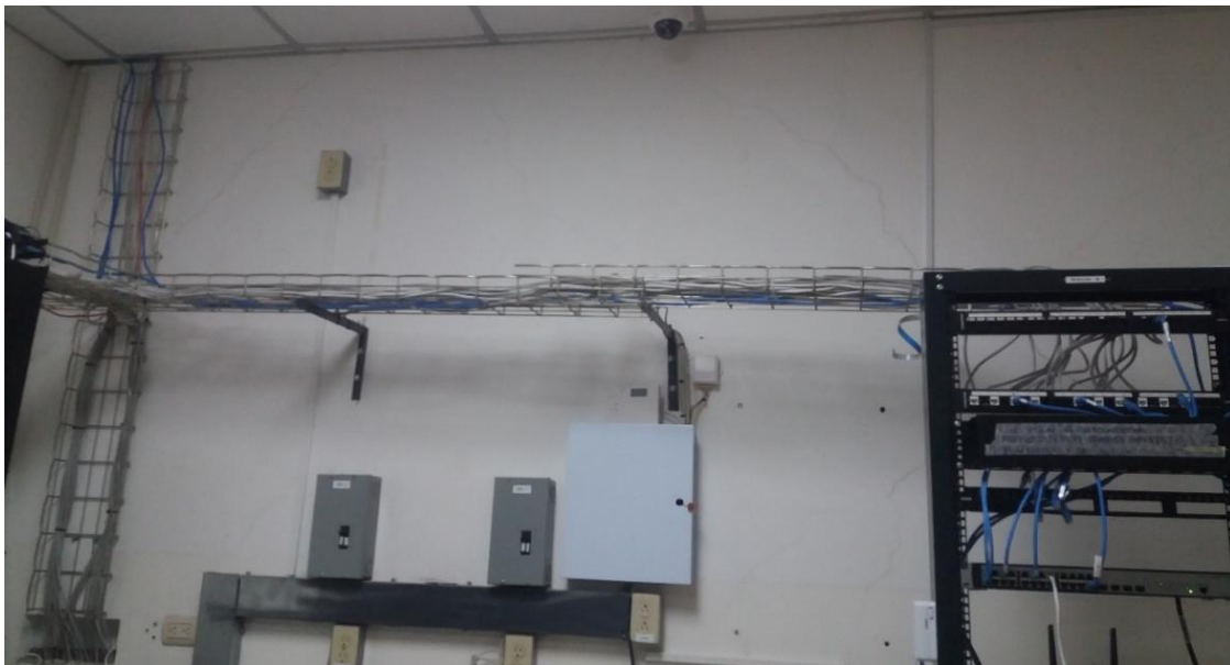
Figura 62: Escalerillas de cable estructurado.
