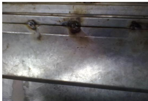
Imagen 8: Punto de soldadura en puerta metálica
