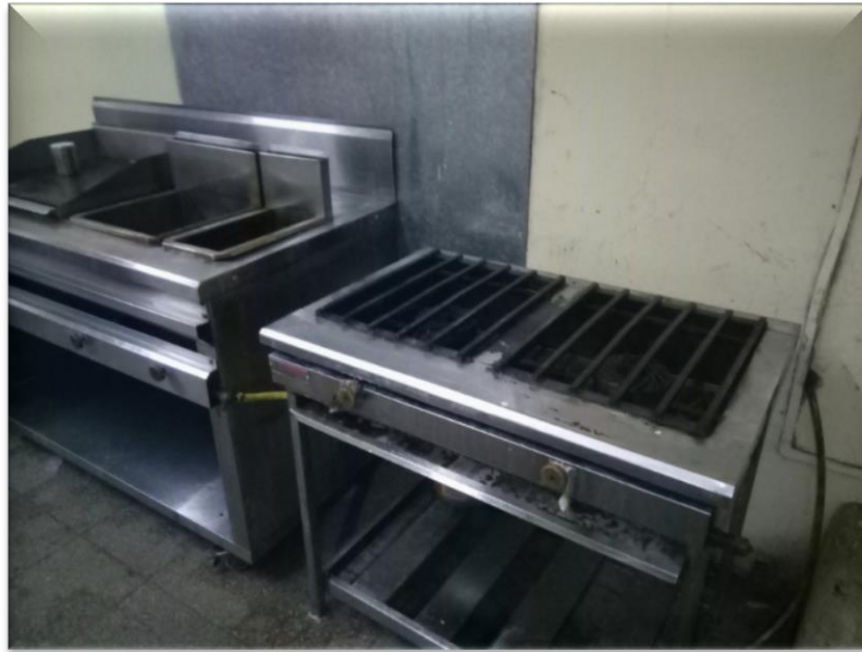
Cocinas industriales usadas en el local de comidas rápidas
