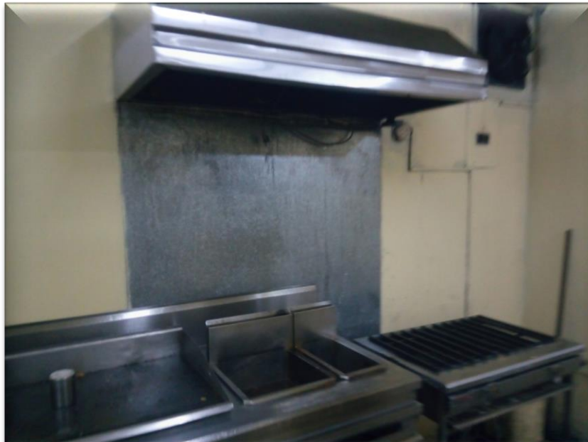
Un solo extractor para dos cocinas industriales
