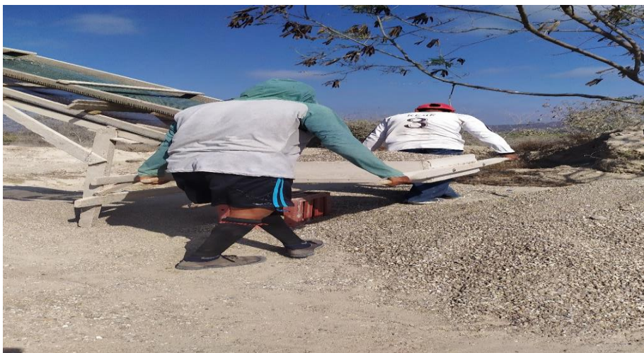
No se utilizan los equipos de protección.
