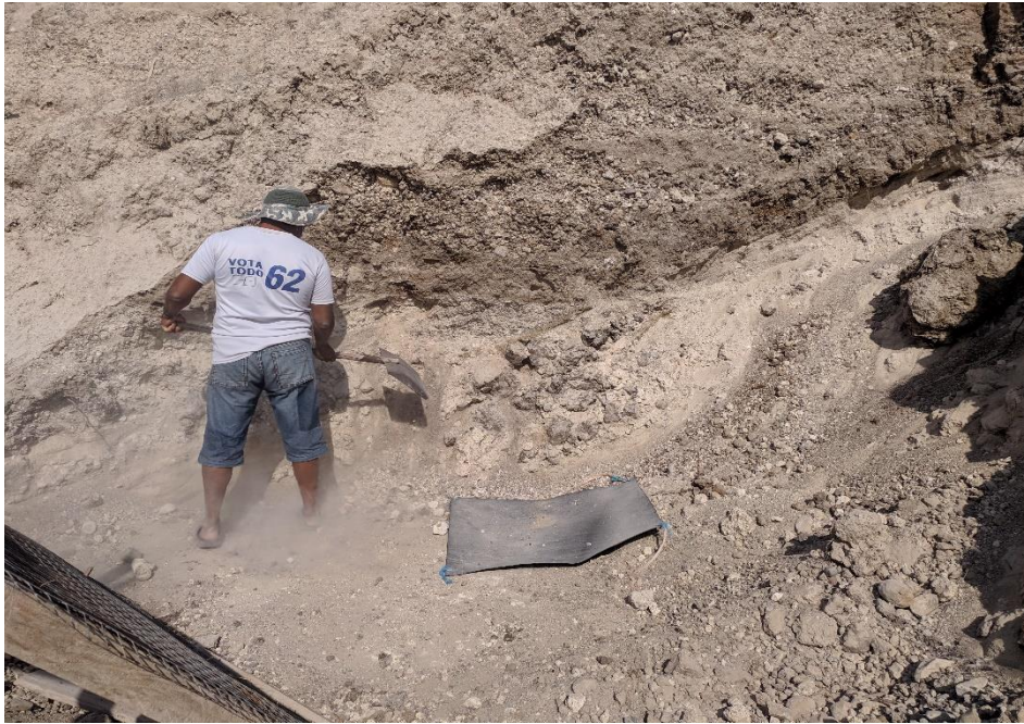
Evidencia de que laboran en lugares donde se pueden ocasionar derrumbes.
