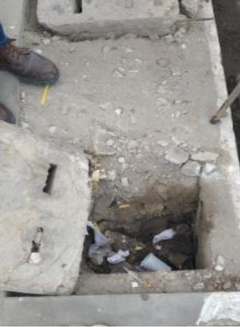
ANEXO # 3 Alcantarillas en mal estado
