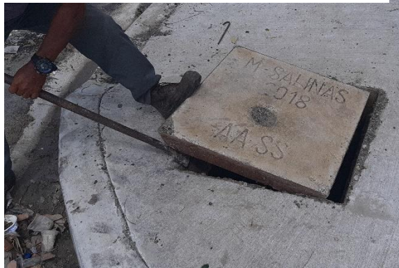
Foto #1: estado Actual de las tapas H.S
