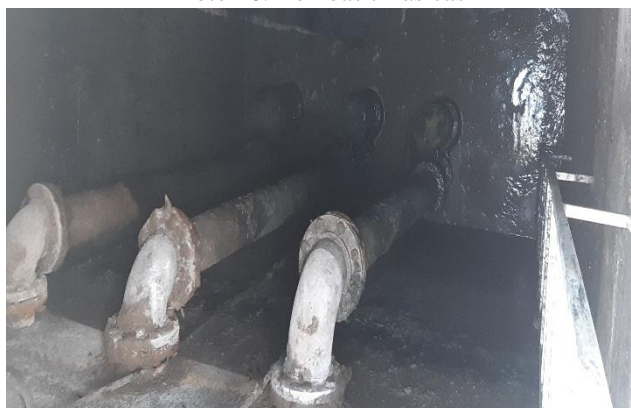
Foto #6: Bombas trifásicas
