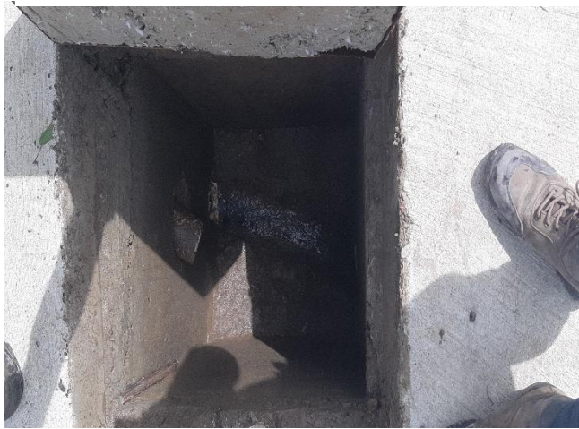
Foto #2: Estado de las cajas de inspección
