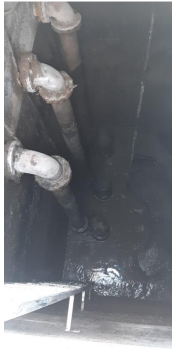
Grafico #4.- Cárcamo de bombeo sumergibles #1 y #2 y tubería de impulsión de D=100mm, Estación de bombeo Barrio Carmen Buchelli - Anconcito
