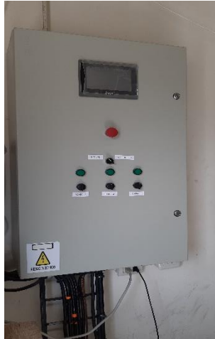
Foto #4: Tablero de control de Bombas
