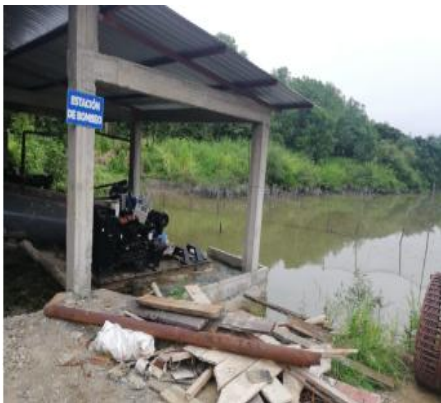
Fotografía 3 Bombas y turbinas
