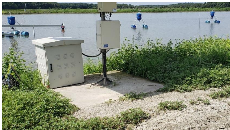
Figura 5. Alimentadores System AQ1, controlador, FS200
