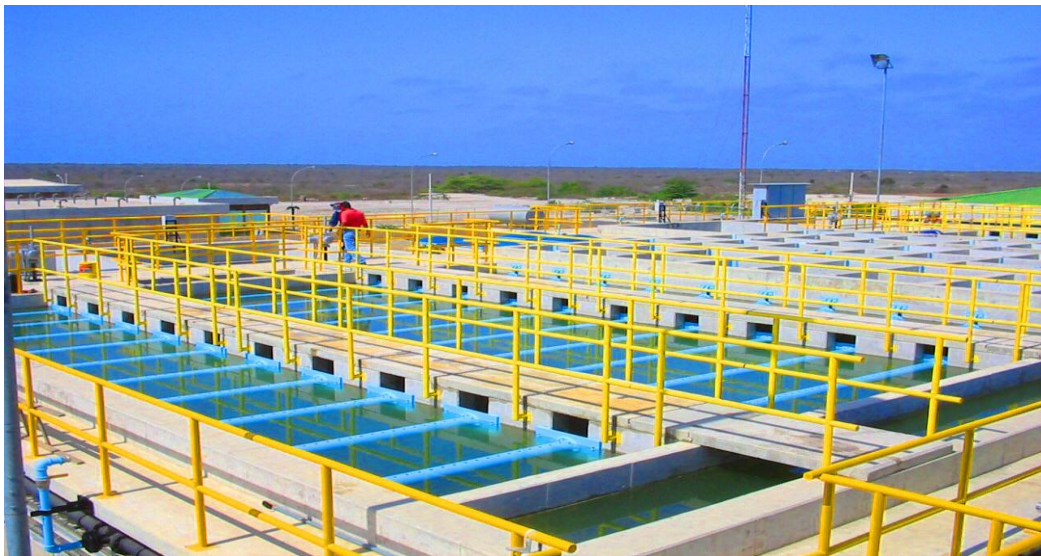
FOTO 4: Planta potabilizadora de Atahualpa
