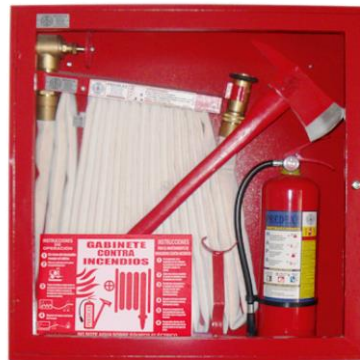
Gabinete contra Incendios con sus Elementos
