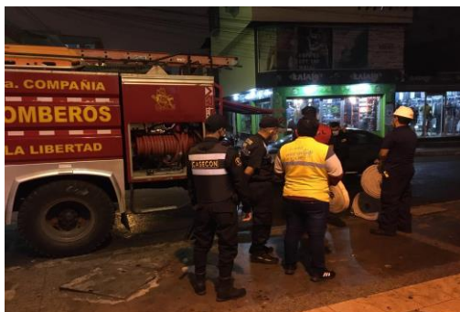
Prueba del Sistema Contra Incendios del Centro Comercial Buenaventura Moreno
