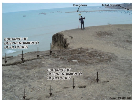
Figura 5. Evidencias de escarpes continuos de desprendimiento de bloques.
