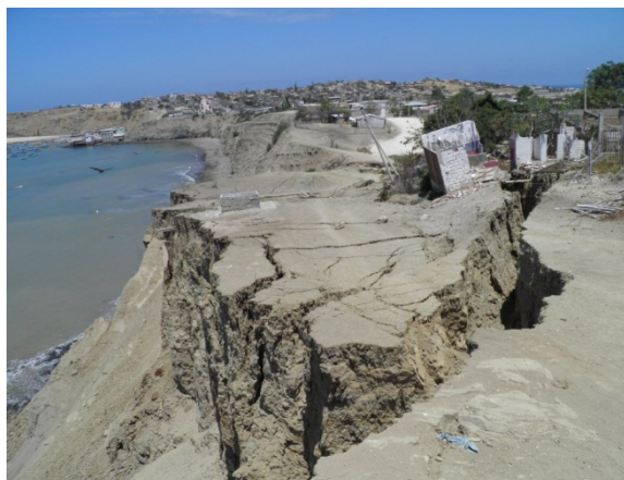
Figura 9. Vista panorámica mostrando la dimensión del desprendimiento del acantilado y el colapso de estructuras edilicias.
