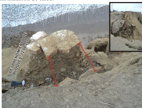
Figura 4. Desprendimiento en bloques de estratos rocosos de areniscas grauwáticas intercalada con laminaciones de arcillolita.
