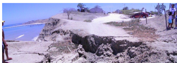
Figura 12. Vía o acceso vehicular construido en Agosto y Septiembre de 2010, la foto indica que la obra no tuvo planes de prevención y selección de sitios adecuados para construcción vial.
