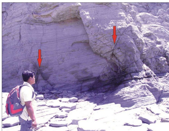
Figura 10. Fracturas por tensión en la base del acantilado.
