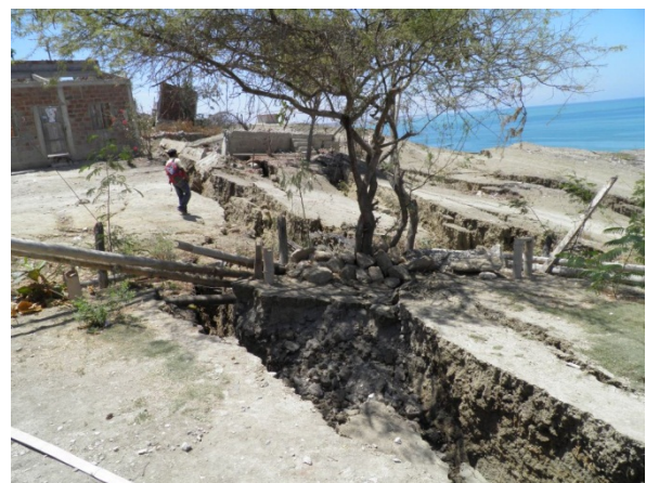
Figura 8. Grietas profundas alcanzan el metro de ancho y cerca de 10 metros de profundidad, producto del desprendimiento del 07.04.2011.
