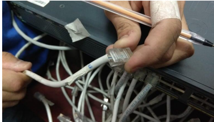
Figura 21: Estado de los cables de red Fuente: Elaborado por autor
