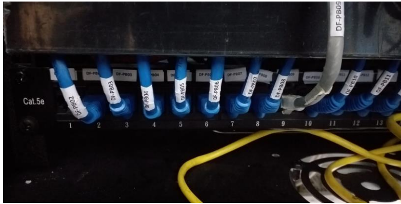
Figura 41: Etiquetado de los patch cords: extremo patch panels Fuente: Elaborado por autor
