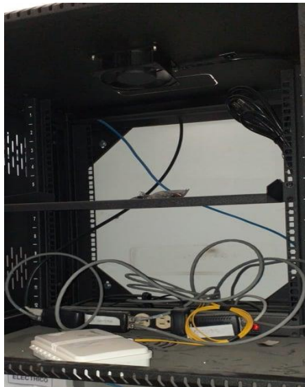
Figura 20: Interior del rack de Pared Fuente: Elaborado por autor
