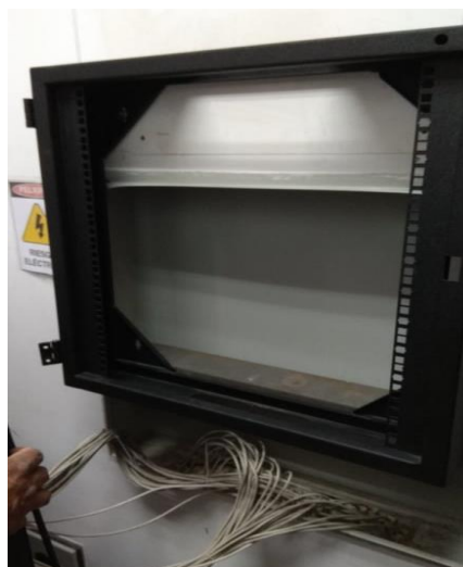
Figura 33: Ubicación de soporte posterior del rack Fuente: Elaborado por autor
