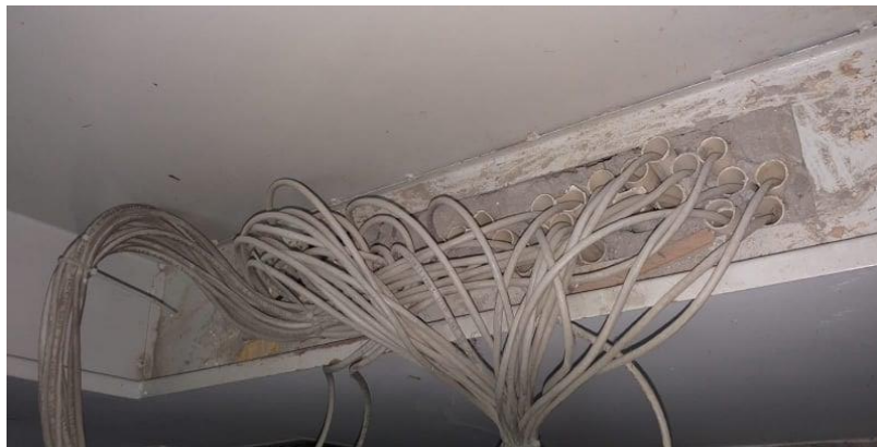
Figura 32: Canalizaciones del cableado horizontal Fuente: Elaborado por autor
