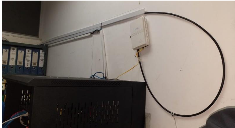
Figura 35: Canalizaciones de cable de fibra y cables de cobre Fuente: Elaborado por autor
