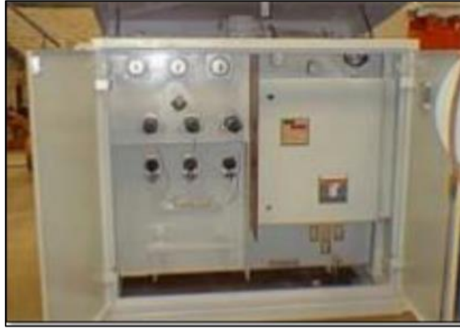
Figura 10. Transformador (Figueroa y Tibaduisa, 2016)
