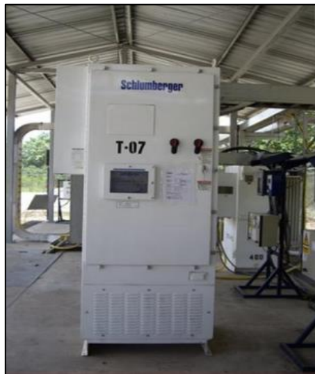
Figura 12. Variador de frecuencia (Chuquimarca, 2015)
