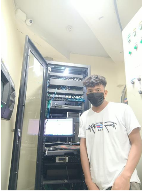
Acceso al Clúster de Servidores
