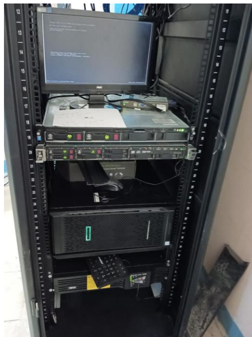
Servidor ABC Y Servidor DEF
