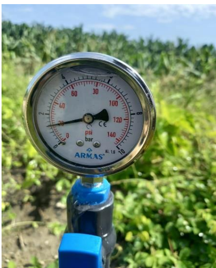
Anexo 3. Manómetro marcando
