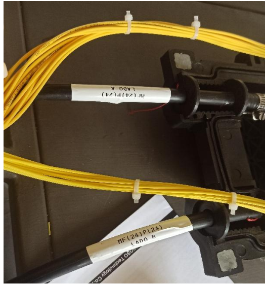
Figura 62. Etiquetado de empalme troncal
