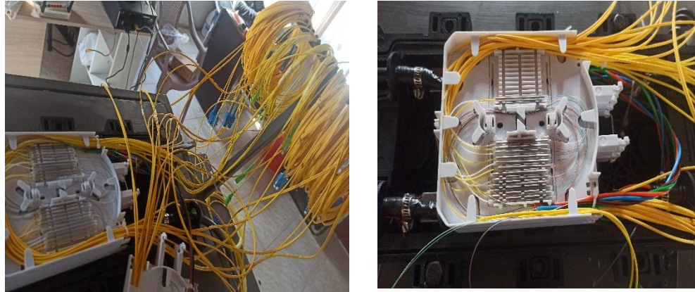
Anexo 4. Ordenamiento de patchs cord en los platos porta empalmes
