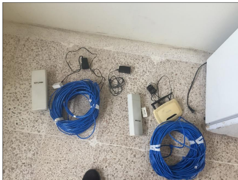
Figura 31 Equipos de red PTP
