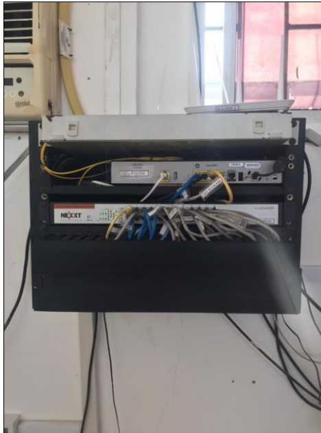
Figura 15 Identificación del cableado del rack
