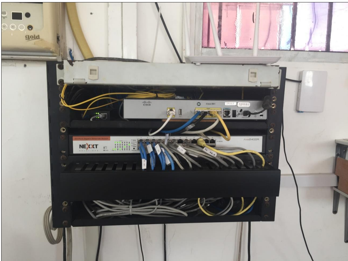
Figura 12 Ordenamiento del cableado al rack
