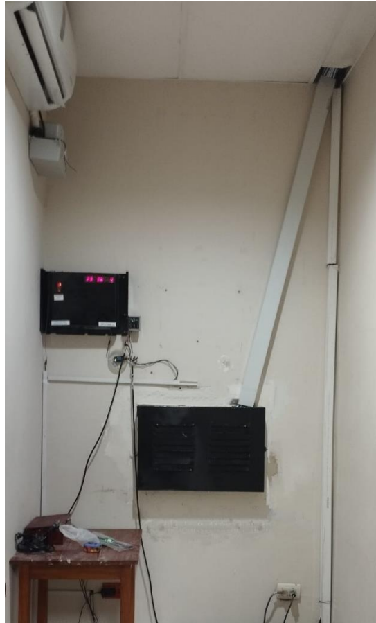
Figura 31: resultado final del cuarto de equipos Fuente: Elaborado por autor
