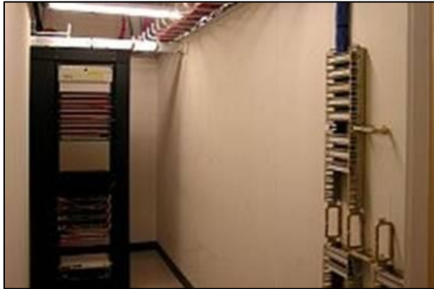
Figura 11: Cuarto de Equipamiento. Fuente: BIRTLH[30].
