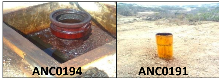
Fig. 19 Cabezales de pozos de HL. Fuente: Pacifpetrol.
