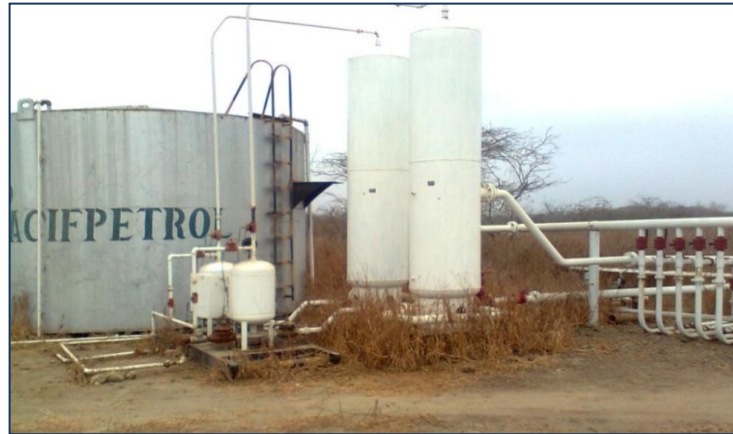
Fig. 20 Subestación Fuente: Pacifpetrol.
