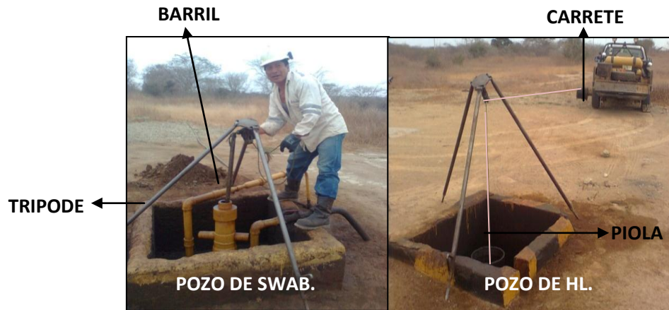
Fig. 15 Equipo de wire line Fuente: Pacifpetrol
