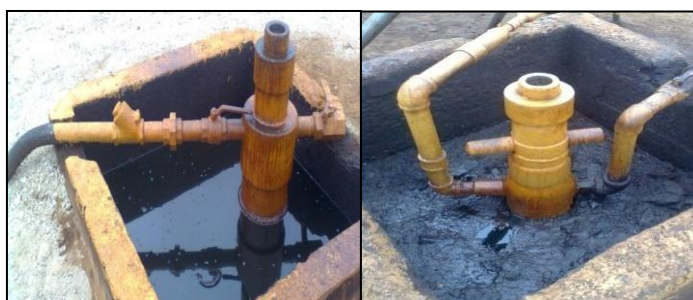
Fig. 18 Cabezales de pozos de SW.
