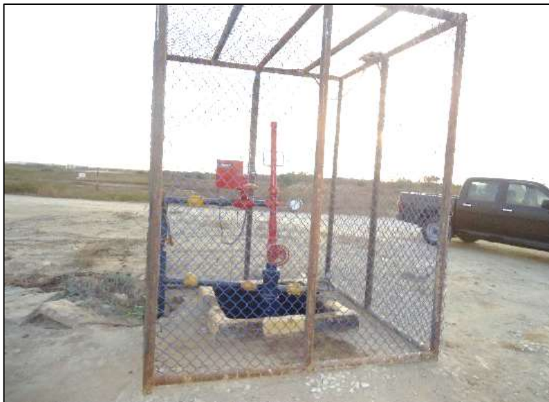
Fig. # 5: Sistema de extracción por Plunger Lift. Fuente: Pacípetrol S.A.
