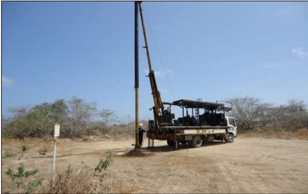
Fig. # 7: Sistema de extracción por Herramienta Local Fuente: Pacifpetrol, S.A.
