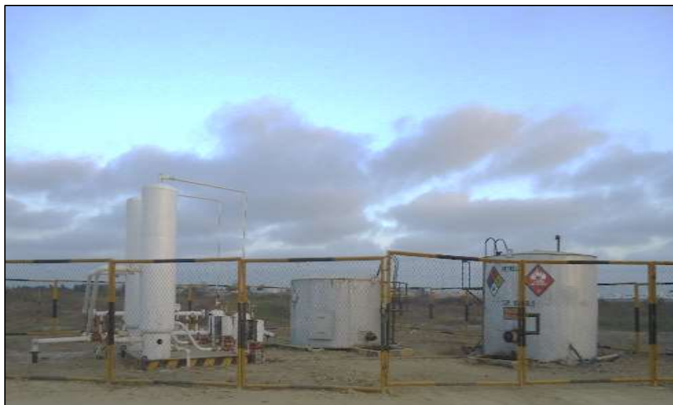
Fig. # 10: Ubicación de los tanques de almacenamiento Fuente: Pacífpetrol S.A.
