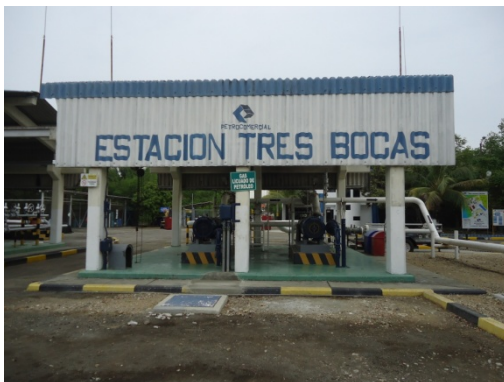
Grupos de bombeo GLP
