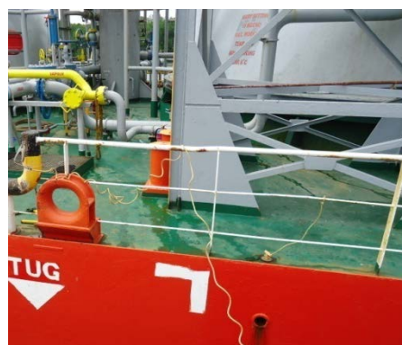
Fotografía 25: Conexión a tierra del B/G
