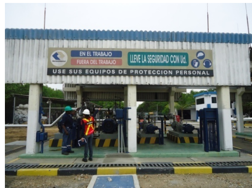
Verificación de Grupos de bombeo
