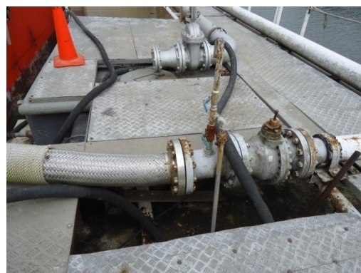
Fotografía 23: Válvula de paso segura
